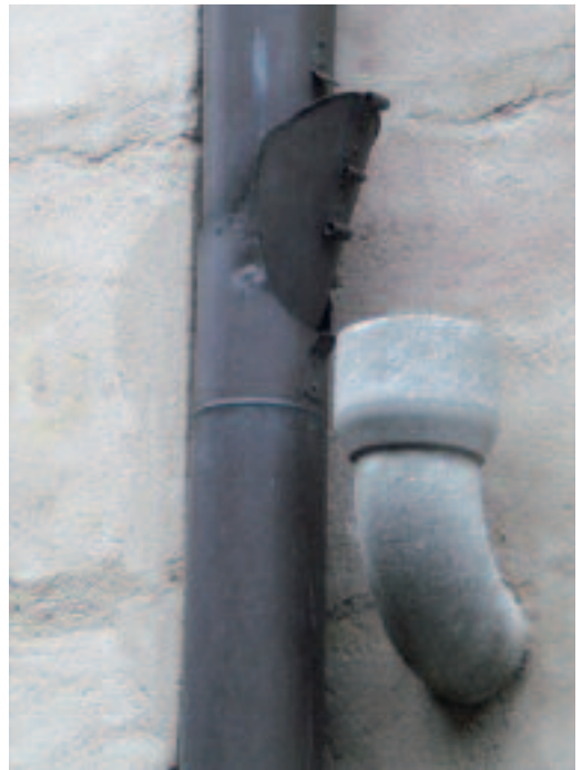
Einleitung von Regenwasser in die Mikwe Hallemannstraße
